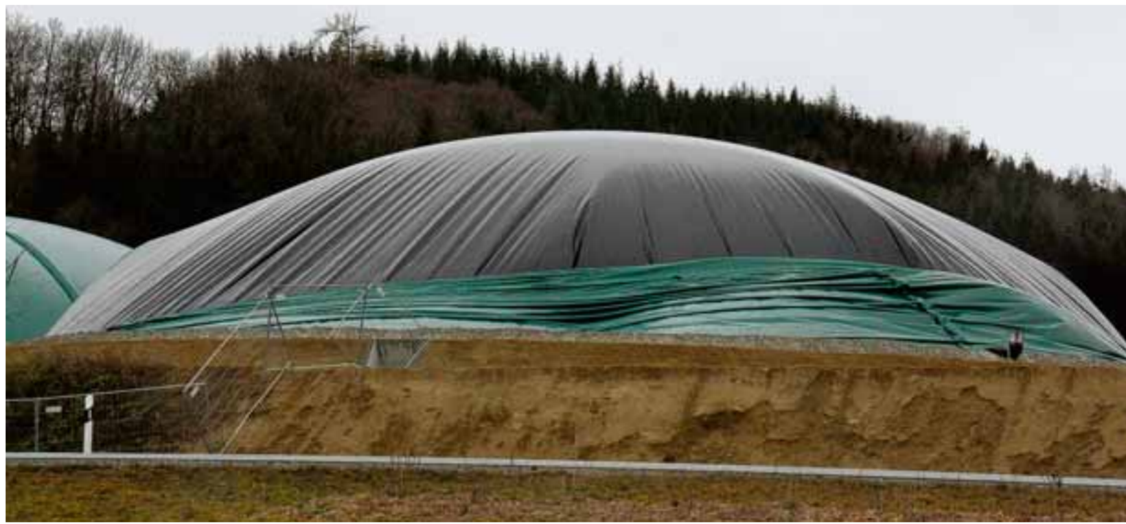
Am rechten Fermenterturm der Biogasanlage bei Jedesheim hat der Sturm die grüne Abdeckplane aufgerissen und heruntergezogen.
